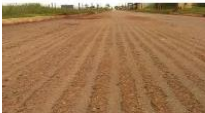
Figura 74- Registro de falha de bico na aplicação de pintura de imprimação
