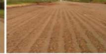
Figura 4 – Detalhe da ausência de mistura asfáltica nos locais onde ocorreu a falha na pintura
